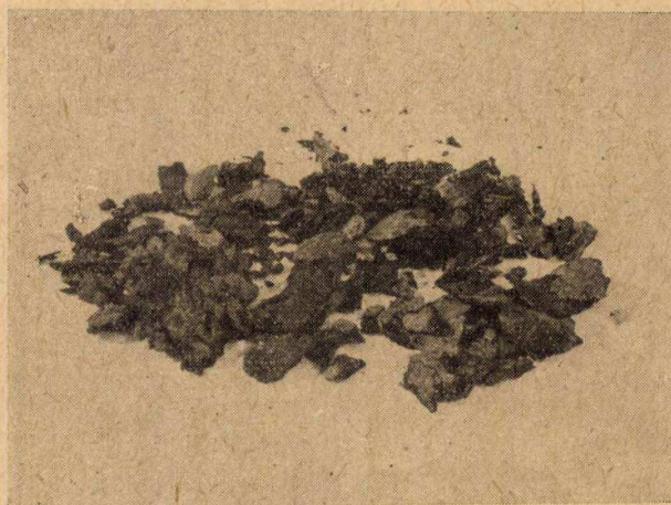
3. ábra. A IV. vonal páncélzatról lefejtett elkorhadt kenderfonal rétege
