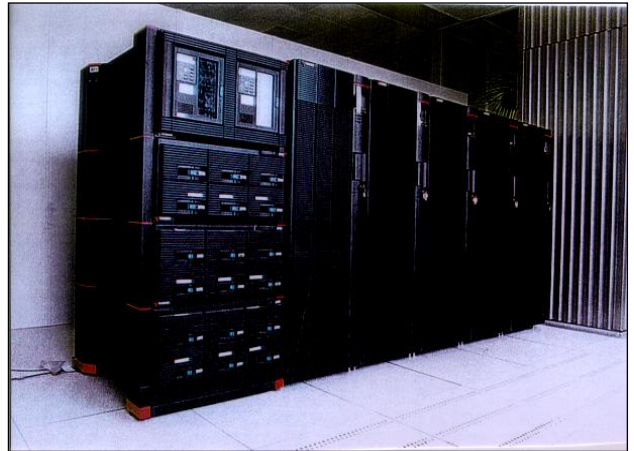
1. kép A SzIR hálózat Siemens-féle EWSP típusú adatkapcsoló központja
