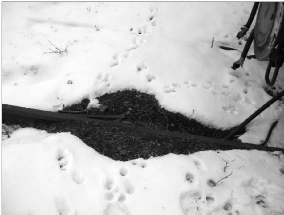
Hibás hevederátkötés hóolvasztás üzemmódban
