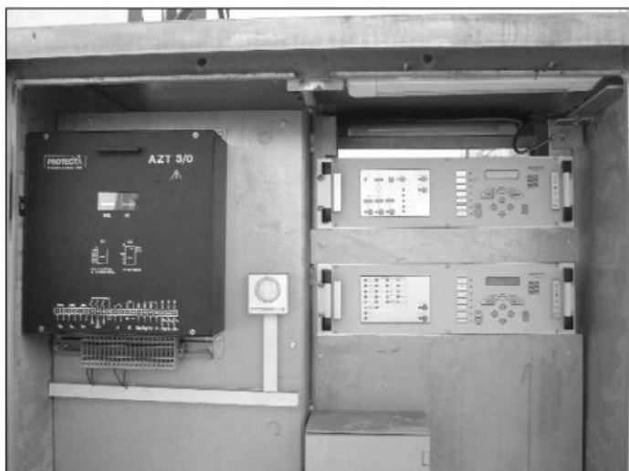
Korszerű digitális védelmek egy felújított előfűtő berendezésen
